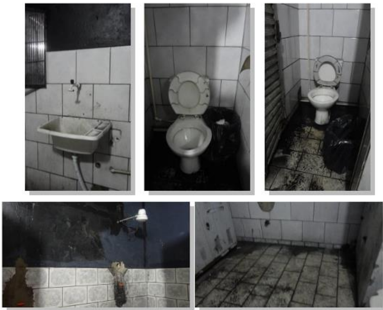
Figuras 05 a 09: Os banheiros, além de estarem subdimensionados (um lavatório e um chuveiro para mais de dez trabalhadores), estavam em condições muito ruins de limpeza e sem materiais de higiene.
