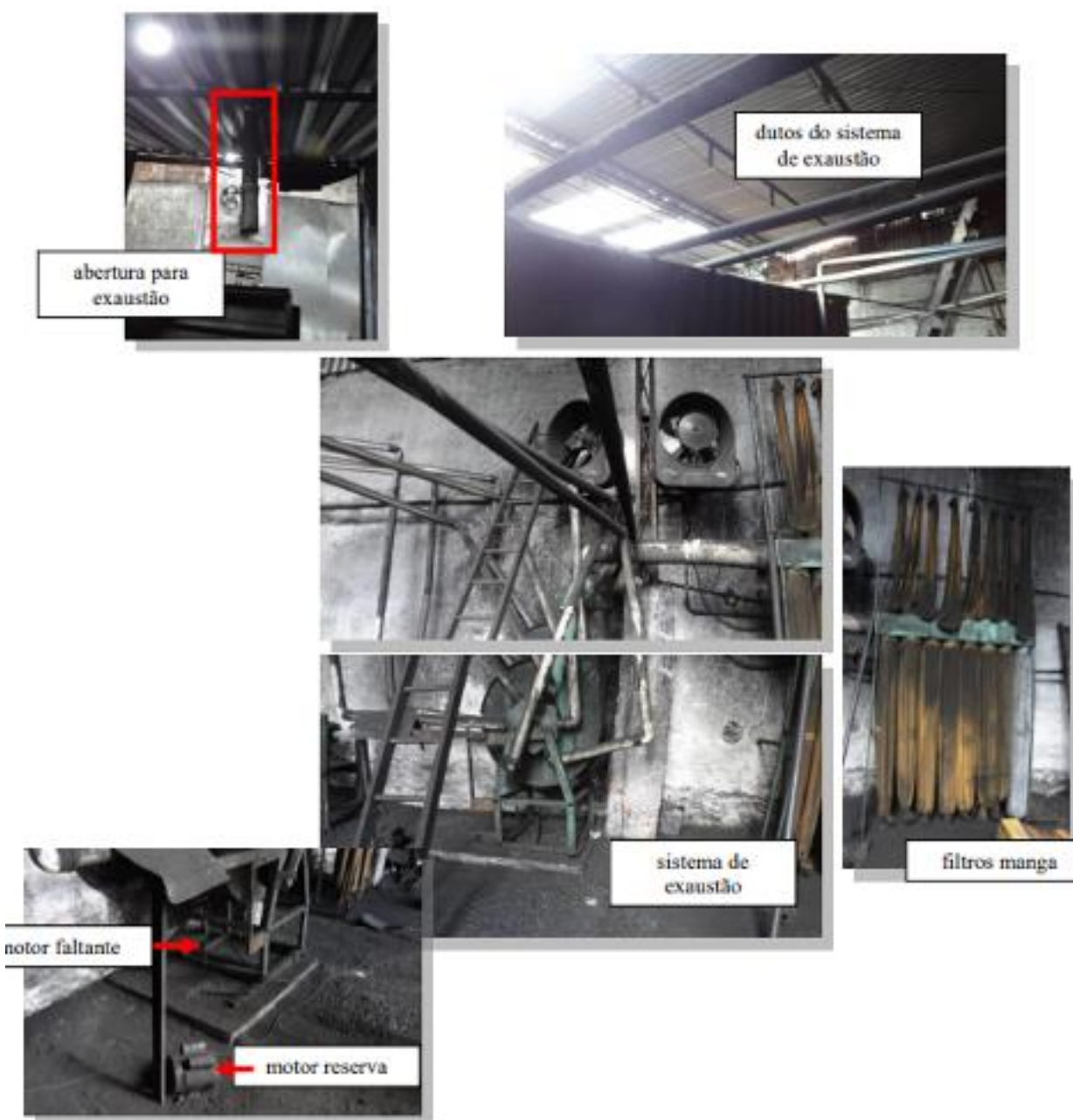
Figuras 15 a 20: Sistema de exaustão encontrado no local.
